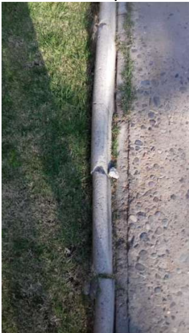
Daño en Solera antejardin
