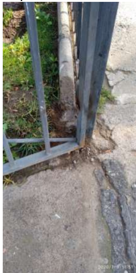
Falta soporte inferior para levantar extremo
