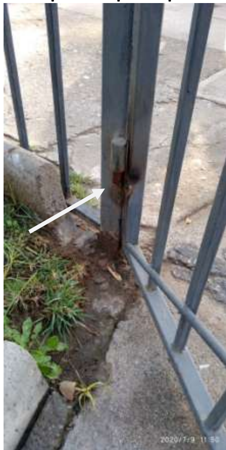
Soporte inferior Bisagra - se desprendio por impacto
